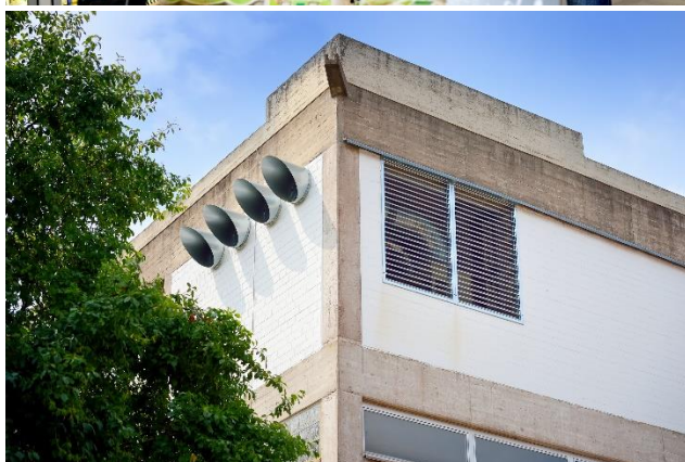
Schalldämpfer in der Maschinenraumbelüftung reduzieren die Schallemissionen der Geräte deutlich.
